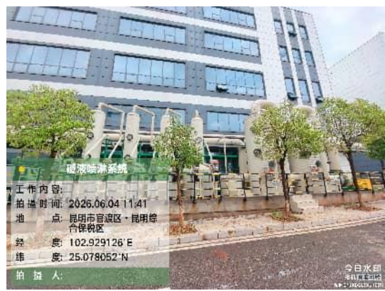
4级射流塔+2级喷淋塔
