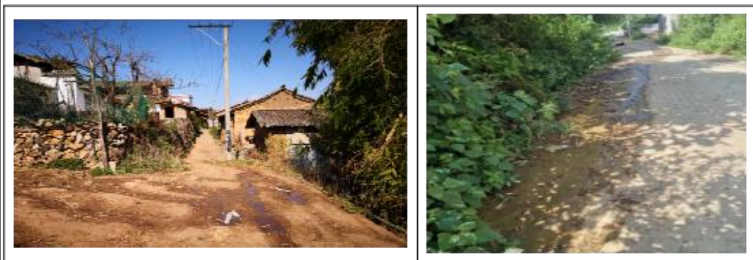
图 3-2 村内道路及排污现状
