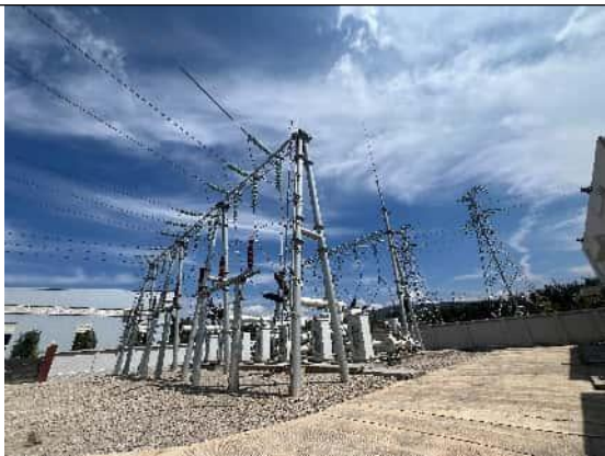
110kV 裕能总降变龙门架
