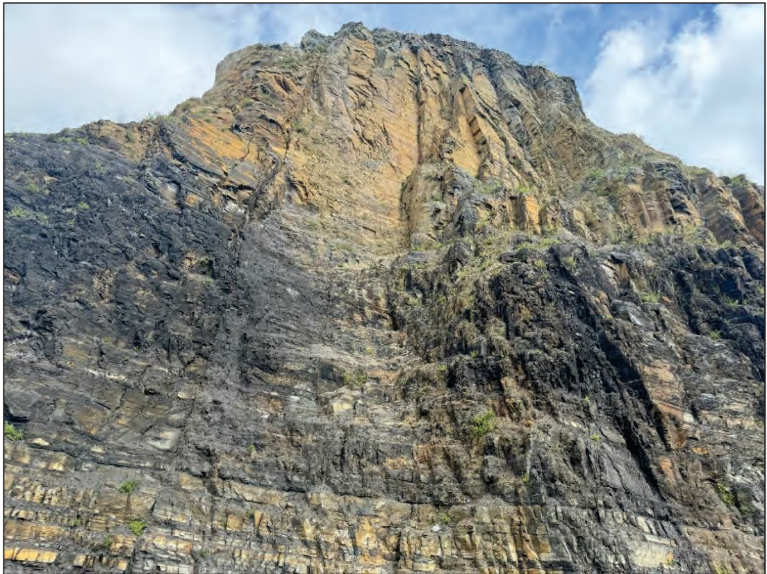
图 2.2-6 B 1 崩塌局部照片
